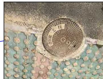
集雨池检查井
