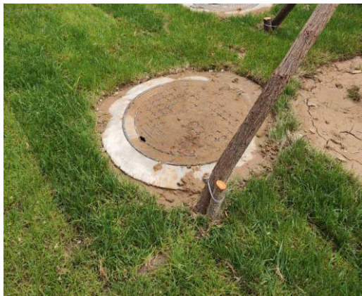
集雨池检查井
